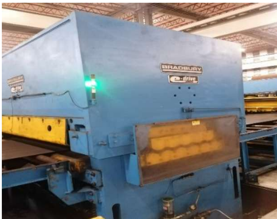
Figura 5. Área de nivelado de acero. Área de nivelado del metal, rodillos de nivelado.
